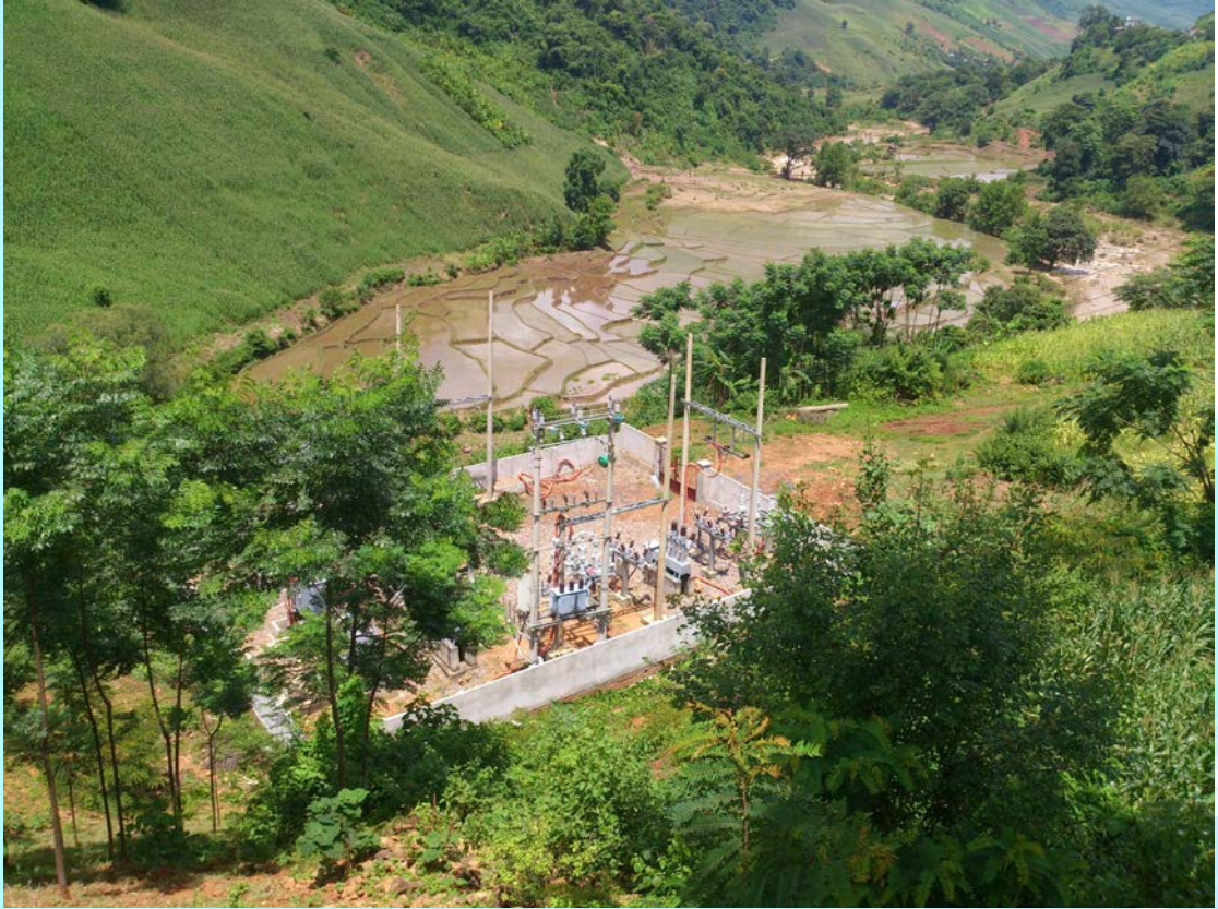
(Hình ảnh: Trạm biến áp 35kv thủy điện Tà Niết)
